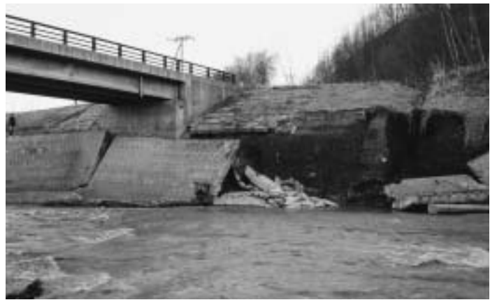
大雨により倒壊した護岸ブロック(合流橋)
