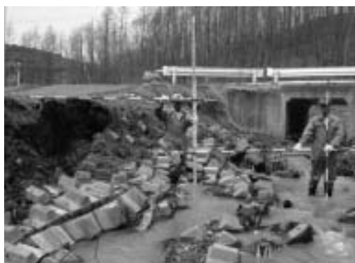
大雨で護岸が崩れたポンイニ川の水位の痕跡を調査
